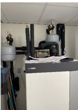
Afb.1: De warmtepomp in het Beatrixhuys.
